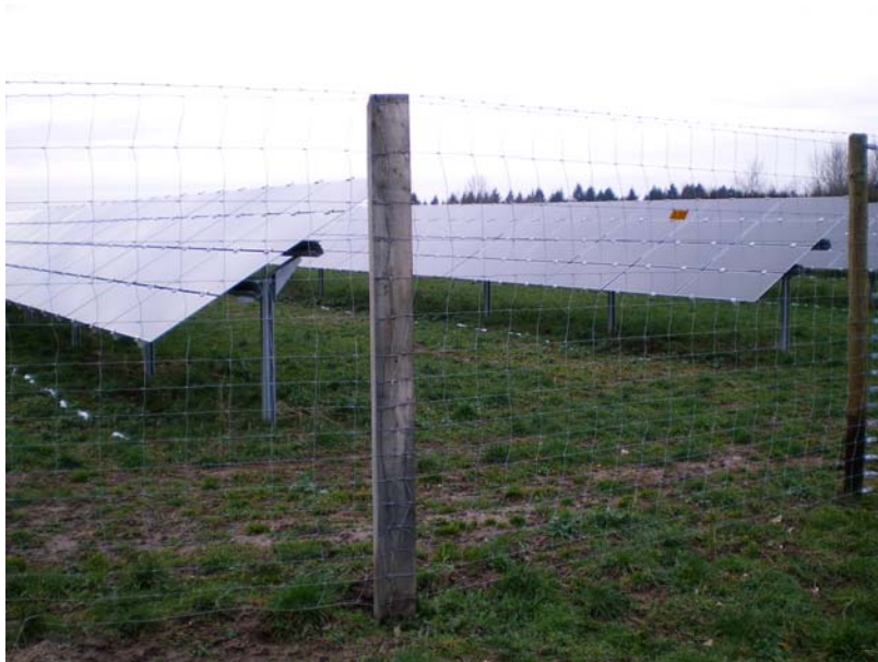
Bsp. baugleiche Anlage
