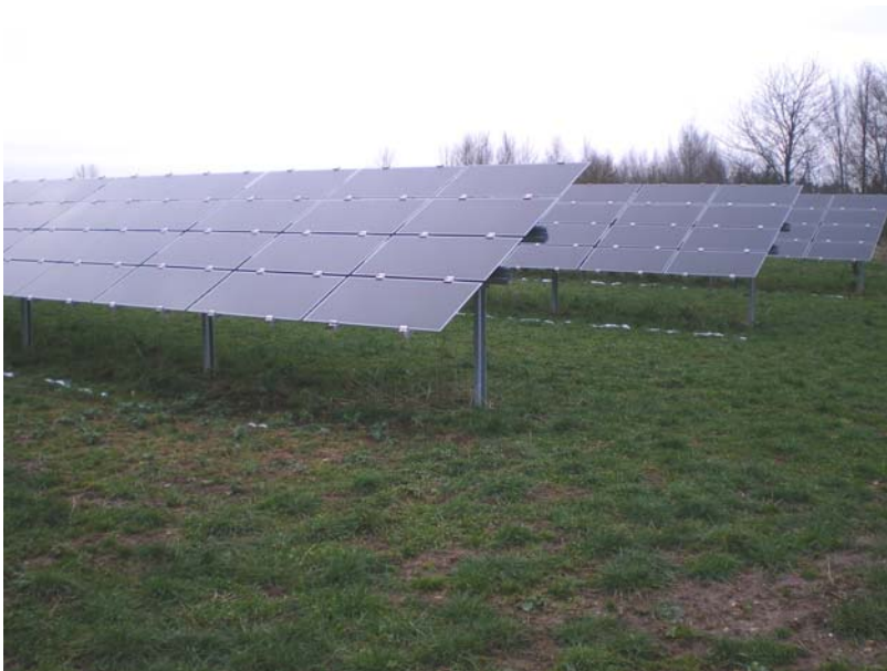
Bsp: Unterkonstruktion Metallständer gerammt, mit ca. 2 m Höhe (Longuich Ackersberg)
